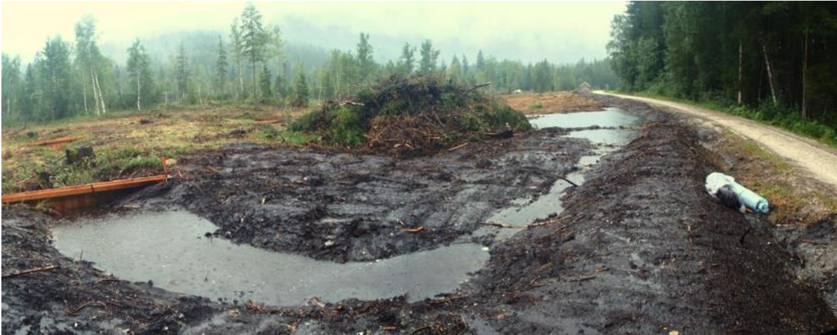
Abbildung 3: Fertiggestellter Spitzgraben mit Damm. Am Ende wurde der Damm in die Fläche gezogen (im Spitzgraben liegt ein übrig gebliebener Folienrest).
