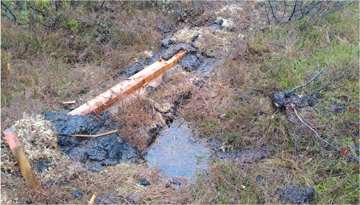
Abbildung 19: Staubildung an einer Spundwand.
